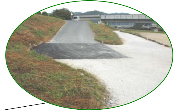
大きな窪みが3個もでき、車や人が通るのが危険なのでアスファルトで舗装（談議所公園）
