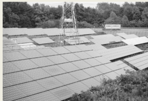
(写真) 山梨県北杜市の太陽光発電所
